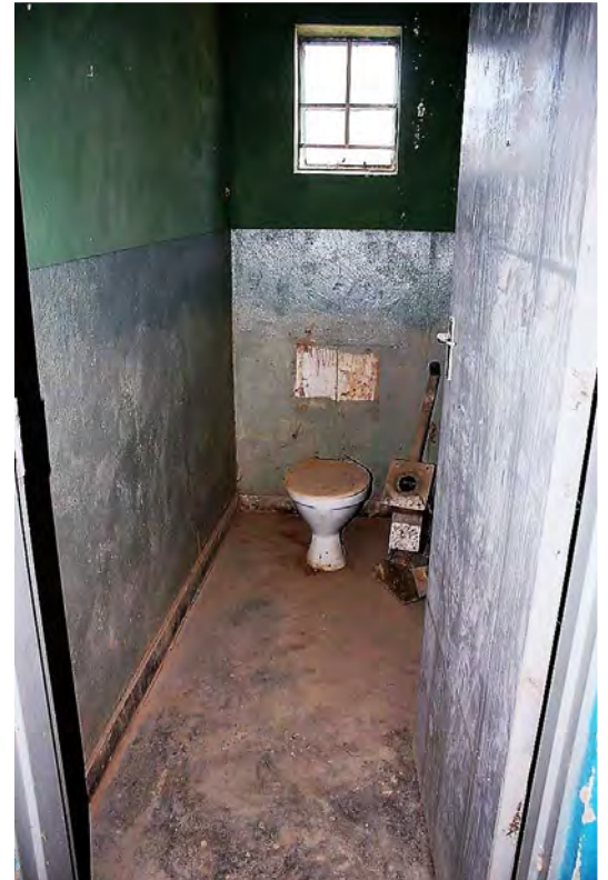
Weil das Wasser fehlt, sehen alle WCs so aus
