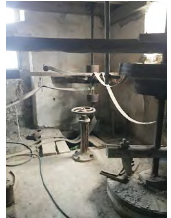
Wasserkraftanlage in der Weissmühle
