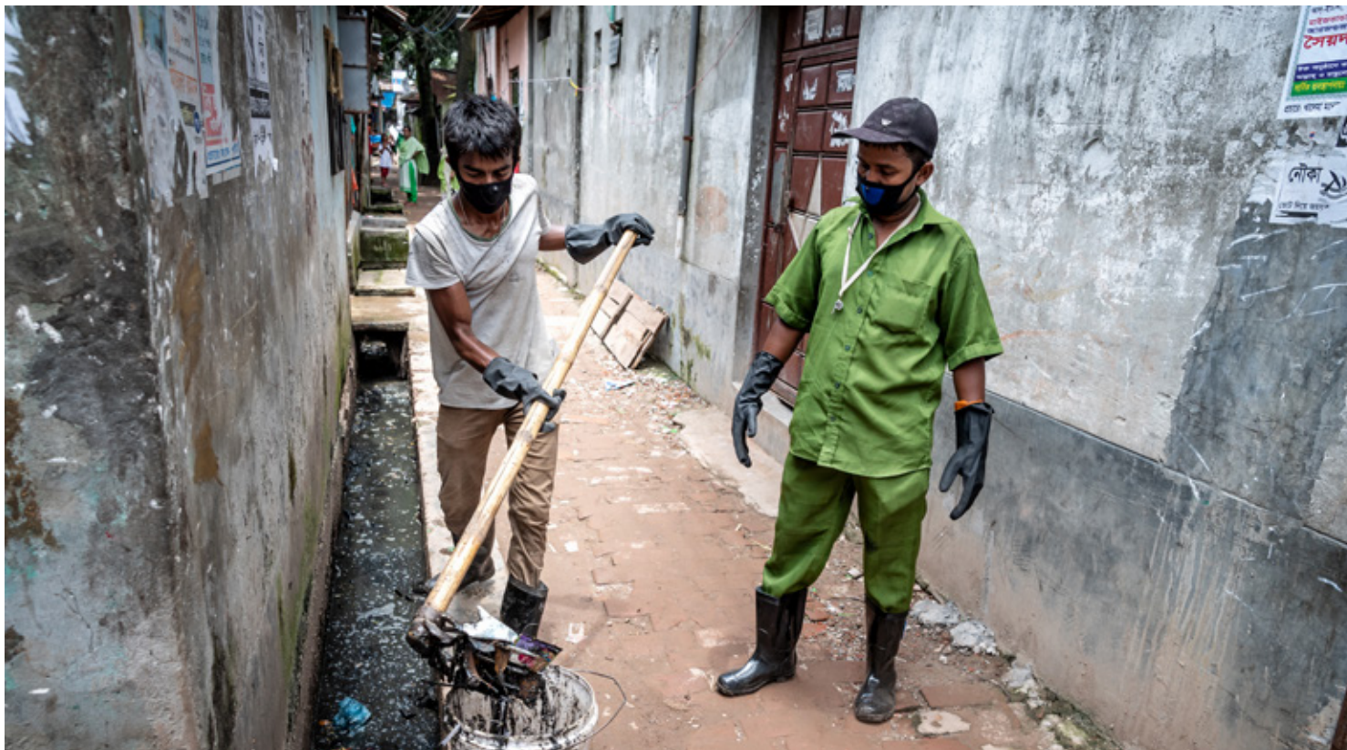
Die Reinigung der Kanalisation ist ein grosses Anliegen der Slumgemeinschaft und beugt Krankheiten vor.
