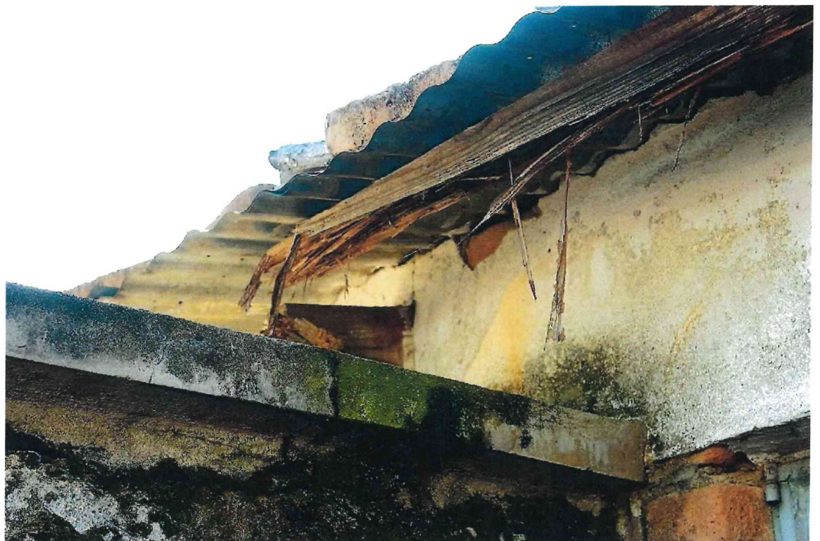
Nicht nur das Dach ist in einem schlechten Zustand
