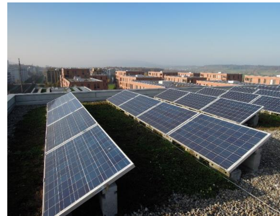
Solaranlage auf allen Dächern der Siedlung Ruggächern
