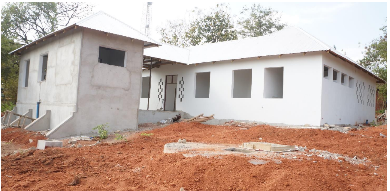
Auf diesem Foto ist die Rückseite des Mütterwartehaus zu sehen. Das kleine Haus ist die Küche, in der die schwangeren Frauen ihre Mahlzeiten vorbereiten können.
